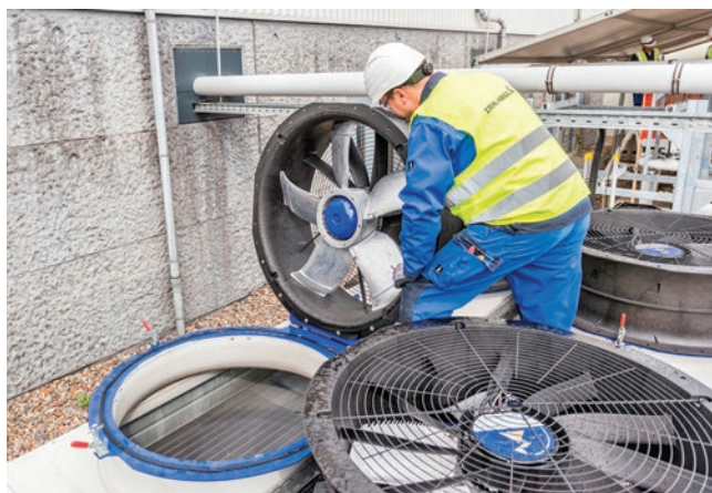
Sustitución ventiladores - Ziehl - Abegg
